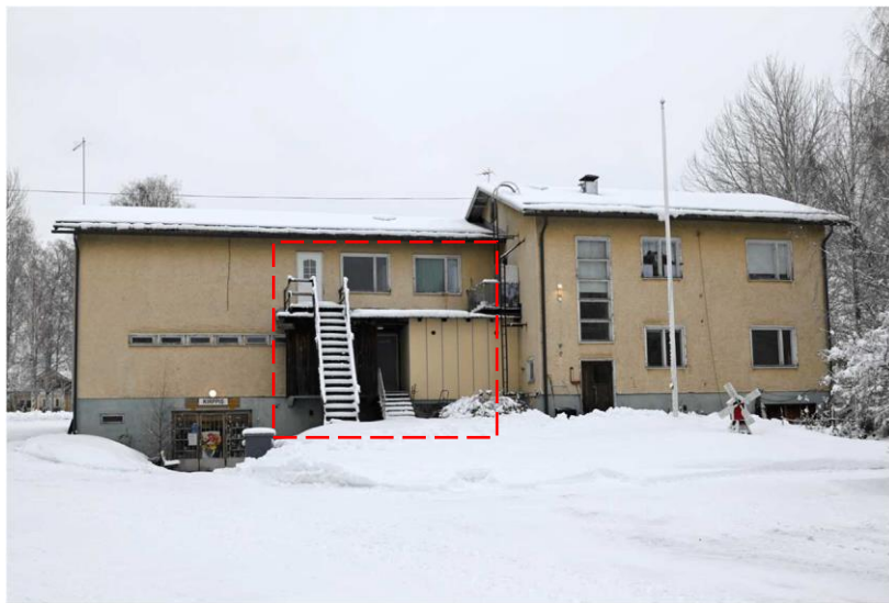
Kuva: Julkisivu länteen. Lastaussillan kohta on kokenut muutoksia. Kellarikerroksen varastotila on liikekäytössä.
